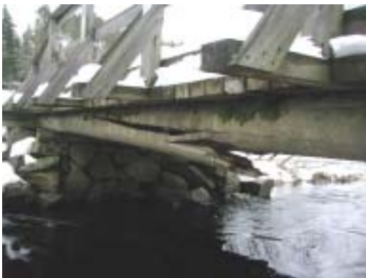
Kuva 13. Kiireellisen korjaamisen tarpeessa oleva puusilta.
